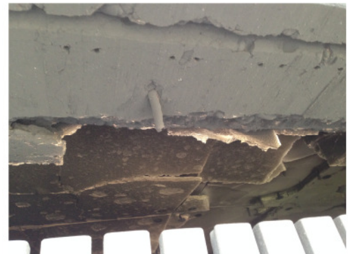
Schäden Tragwerk und Verkleidung
