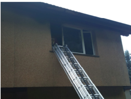
Geborstenes Fenster und Dachuntersicht
